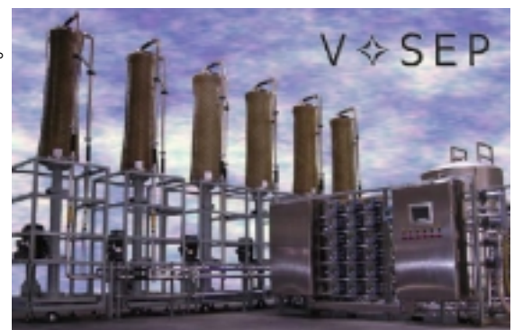
図-6 2700m 3 /日 UF 膜処理システム
